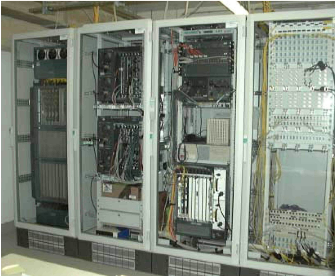
ABBILDUNG 4.5: Die Schaltschränke des DFN enthalten (von links nach rechts): 1. Kernnetzrouter CISCO 12016; 2. Regionale Accessrouter CISCO 12008; 3. Routertechnik für die lokale IP-Vermittlung sowie Geräte für ein von IP unabhängiges Störungsmanagement; 4. Patchfelder mit unterschiedlichen Kupplungen für verschieden Anschlußtypen.
