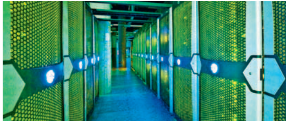
Das HLRN-System am ZIB umfasst insgesamt 49 Computerschränke. Dabei befinden sich die Rechnersysteme in 28, die Plattensysteme in 13, die InfiniBand-Netzwerk-Switche in 6 und die Verwaltungsserver in 2 Schränken.
