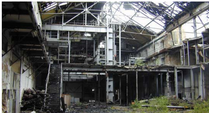
Zuckerfabrik, Bruck/ Laitha + Optik – Nest, Schall, Licht, baufällig, Dach undicht, Anfahrtszeit
