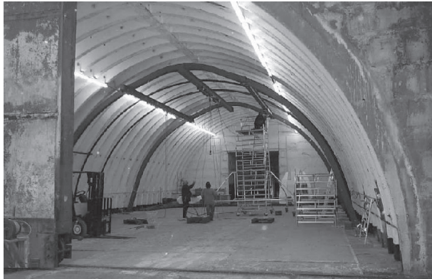
Vorbereitung zur Abnahme vom TÜV
