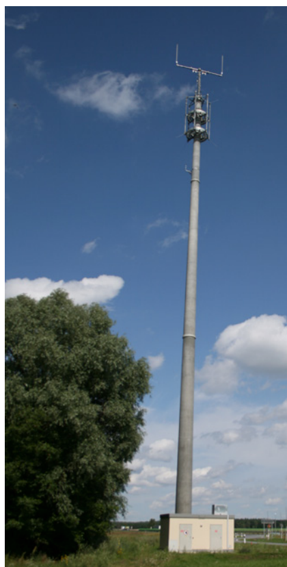
Abb. 1) Foto eines BOS-Digitalfunkmasts mit zugehörigem Funksystemtechnik-Container. Quelle: Projektorganisation Digitalfunk BOS Brandenburg
