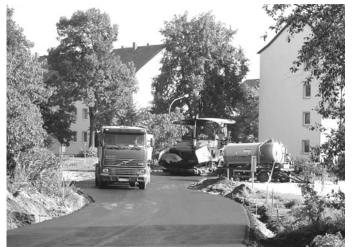
Voll im Zeitplan befinden sich die Arbeiten zum Bau der Ersatzzufahrt zum Gewerbegebiet Schipkau.
