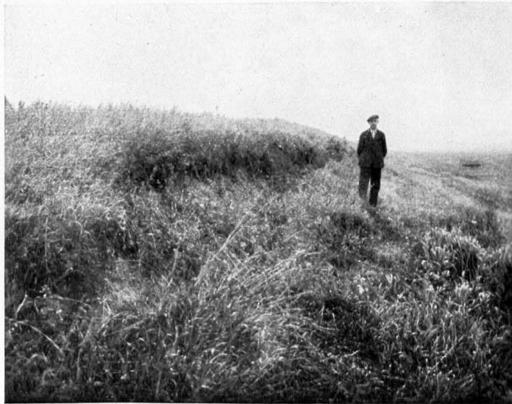
Abb. 1. Deich Stützkow-Schwedt. Polderseitige Böschung mit steilem Winkel und Abbrüchen
