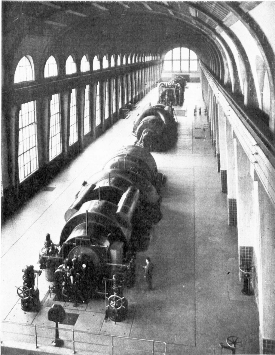
Abb. 5. Turbinenhalle im Groß-Kraftwerk Finkenheerd im Frühjahr 1930
