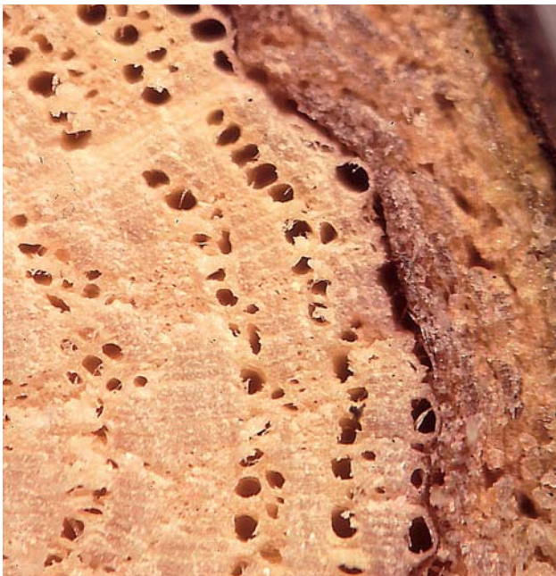
Abb. 2.7.13: Größere Fehlstellen im äußeren Gefäßring der Eiche „ohne“ Blattaustrieb (Mai 2004)
