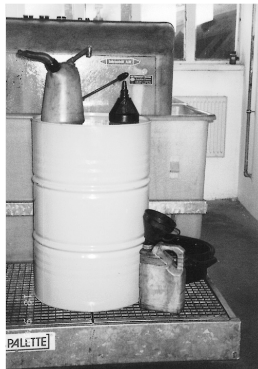
Im Hintergrund des Fotos ein Altöl- und Frischöllagertank (jeweils mit Auffangwanne hintereinanderliegend) einer Ölentorgungs- und Ölbefüllungsanlage in einer Werkstatt eines Autohauses - im Vordergrund ein Frischölfasslager
