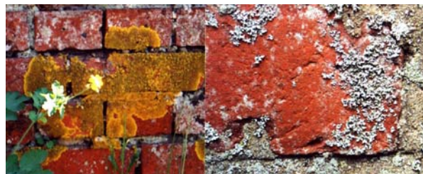
Abb. 57: Flechtenbewuchs an einer Backsteinmauer
