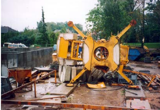
Abbildung 13: Die Baustelle nach dem Kran- umsturz
