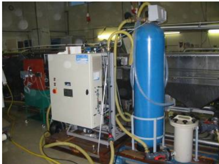
Bild 6: Ozongenerator „Coolzon 8“ mit vorgeschaltetem Grobschmutzfilter (rechts) und Kiesfilter (Mitte, blau)
