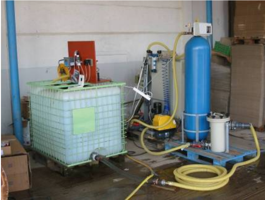
Bild 39: Ozongenerator „Coolzon 8“ mit vorgeschaltetem Grobschmutz- und Kiesfilter, gekoppelt an ein 1 \text{ m}^3 Vorratsgefäß
