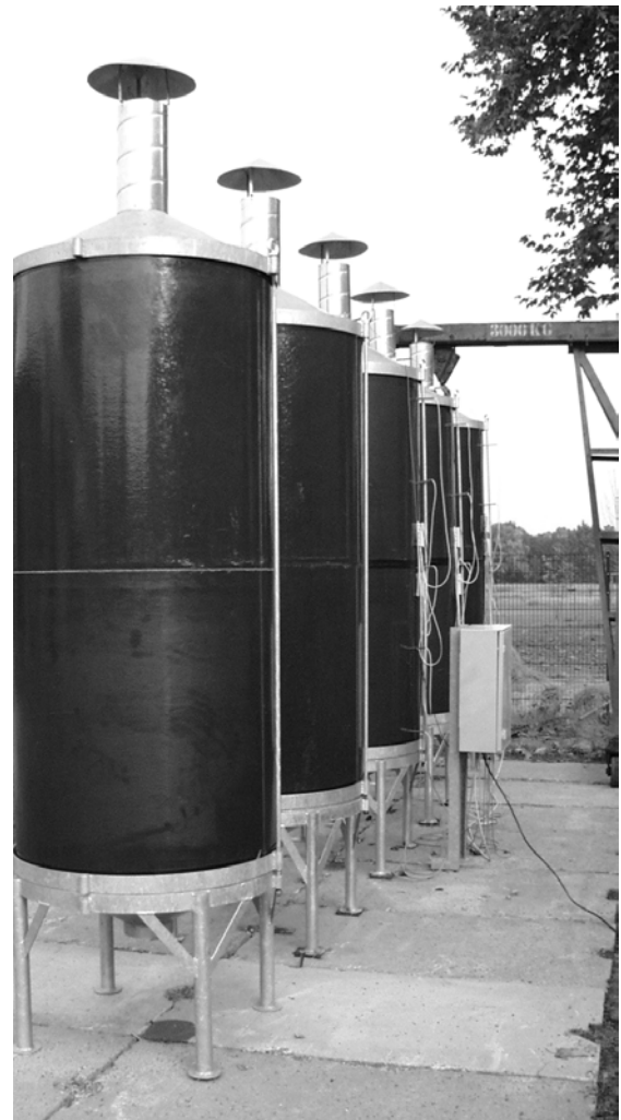
Bild 3-16: Silos mit Messfühlern und Kran
