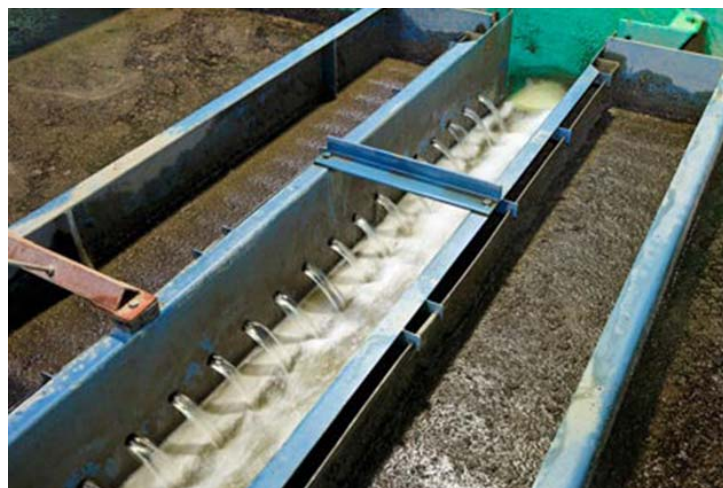
Betrieb einer Bodenwaschanlage
