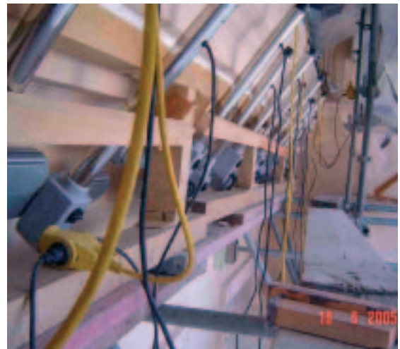
Hellstrahler im Gesimsbereich
