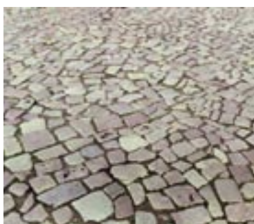
Nicht fachgerecht wieder verlegtes altbrauchbares Polygonalpflaster. Die Fugenausbildung in Form und Größe ist unbefriedigend und damit entsteht kein Pflasterbild.
