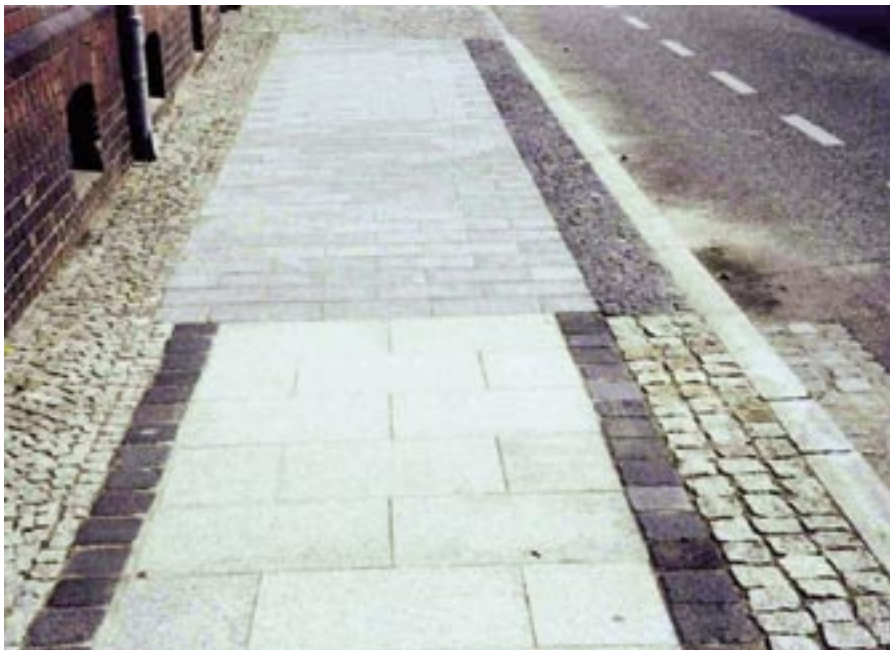
Bei Vorliegen eines Gesamtgestaltungskonzeptes für die Altstadt dürften solche Zäsuren zwischen zwei Bauabschnitten ausgeschlossen sein. Nicht nachvollziehbar bleibt, warum ein derartiger gestalterischer Wechsel nicht vor und nach einer Zufahrt erfolgte.
