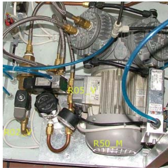
Abbildung 47: Gaseinlassventile und Kompressor
