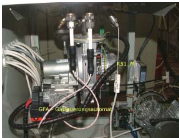
Abbildung 50: Gasfeuerungsautomat und Brennergebläse
