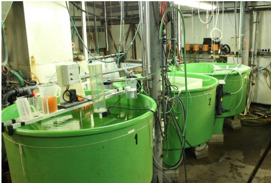
Abb. 22: Brutbecken mit automatisierter Artemien- und Trockenfutter-Verabreichung, großflächiger Oberflächenablaufgitterung für hohe Wasserwechselraten, Bodenräumer zur teilautomatisierten Reinigung und Mikroblasenausströmer zum Reinsauerstoffeintrag.
