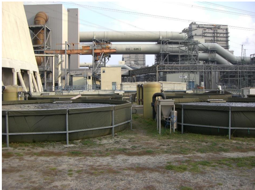
Abb. 18: Mit temperiertem Teichwasser versorgte Beckenanlage in einem Braunkohlekraftwerk.
