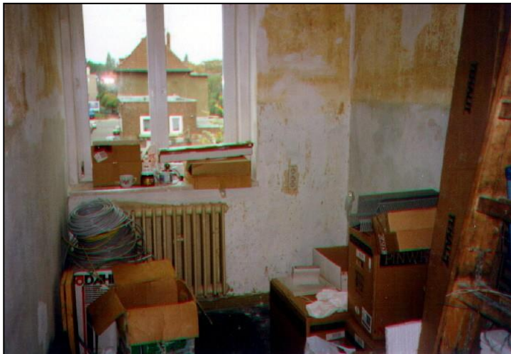
aus Wohnung wird Leitstelle
