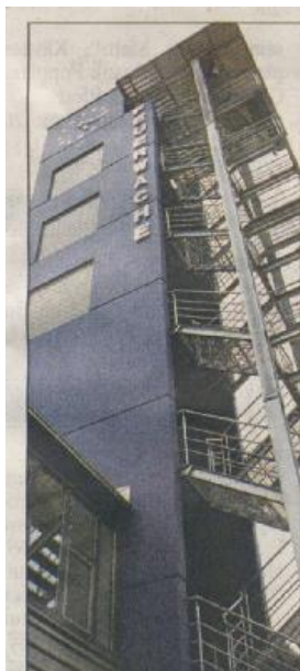
Der 25 Meter hohe Schlauchturm hat Anschluß an die vollautomatische Schlauchwasch- und -prüfanlage.
