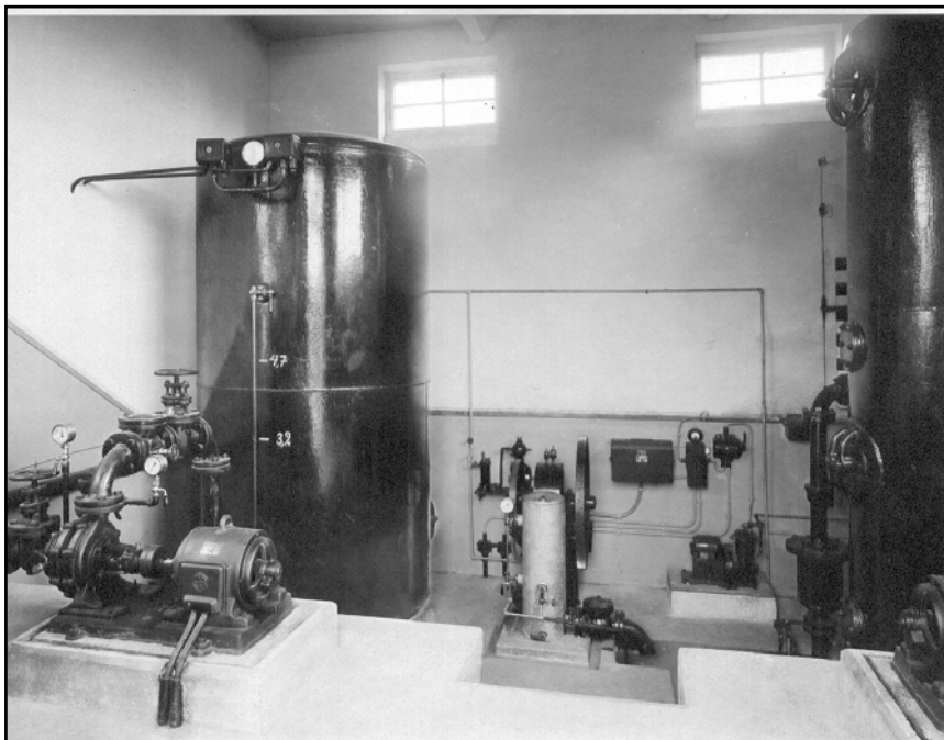
Bild 24: Blick von der Eingangstür in den Maschinenraum 31
