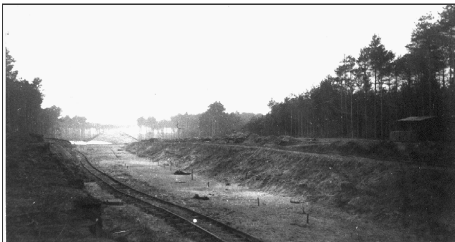
Bild 69: Planierungsarbeiten am Abzweig nach Magdeburg, in den das Feldbahngleis hineinläuft. In der Mitte die Trassierungspfähle
