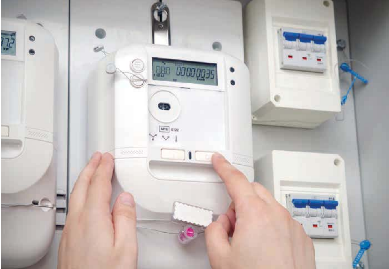
Die neuen Stromzähler – intelligente Messsysteme
