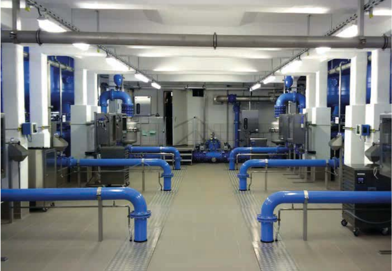
Die sanierten Anlagen der geschlossenen Wasseraufbereitung im Wasserwerk Wildpark
