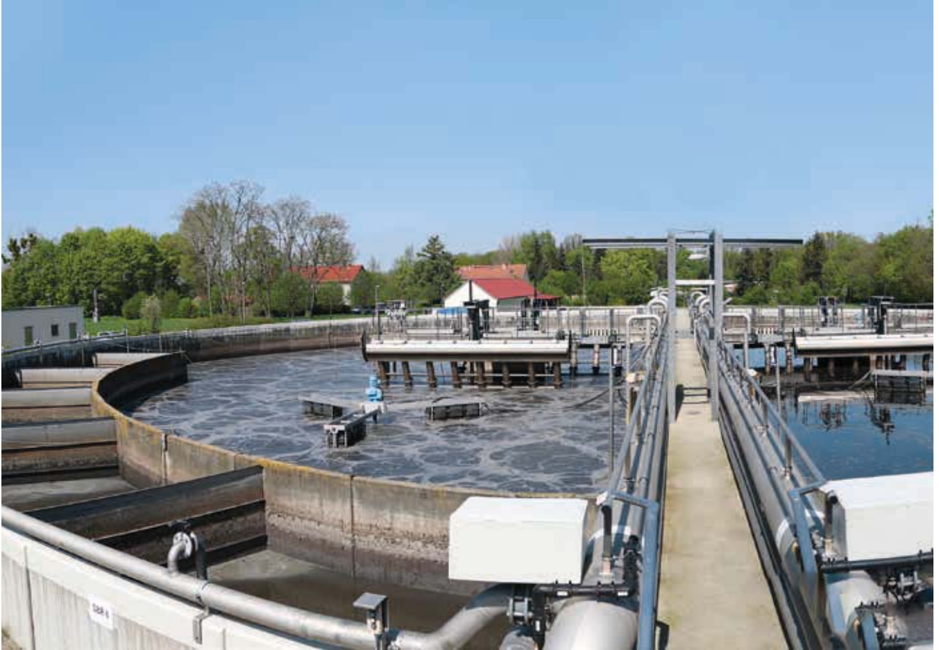
Reinigungsbecken am Klärwerk Potsdam-Nord
