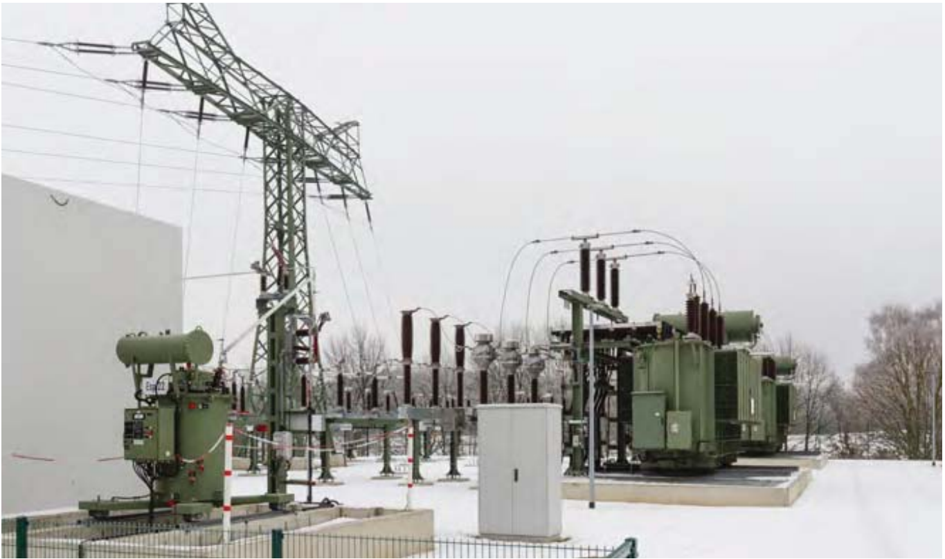
Das Umspannwerk Potsdam-Golm ist ein Beitrag zur Versorgungssicherheit im Norden Potsdams.
