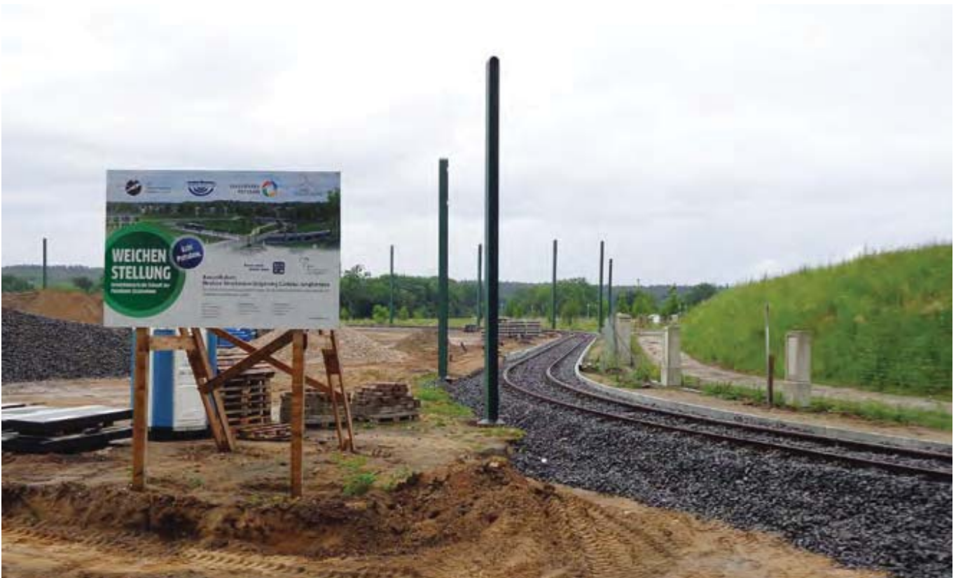
Blick auf einen fertiggestellten Streckenabschnitt an der Wendeschleife Campus Jungfernsee vor Beginn der Oberleitungsarbeiten.
