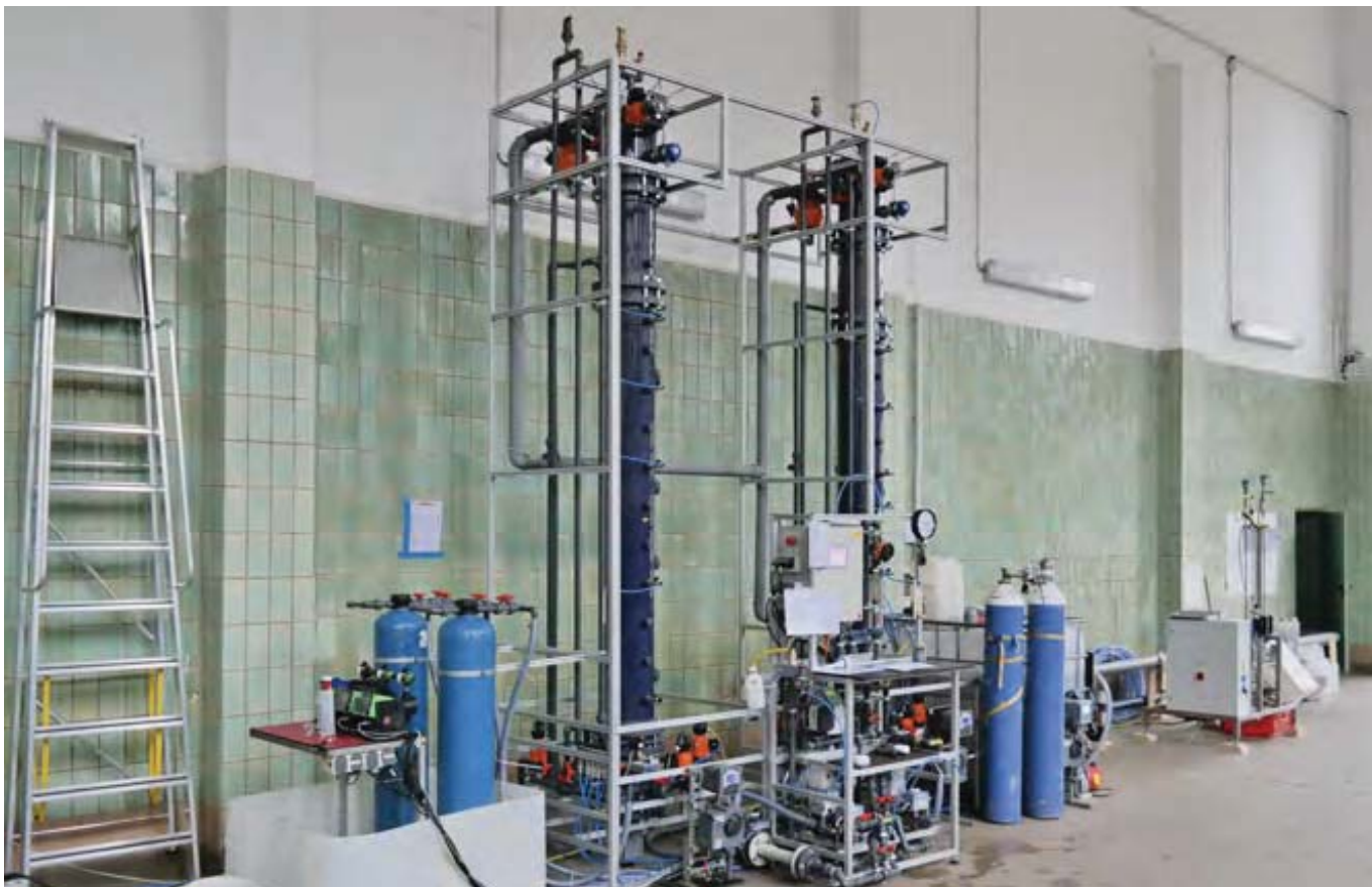
Die gläsernen Filter – Herzstück des Forschungsprojektes im Wasserwerk Leipziger Straße.
