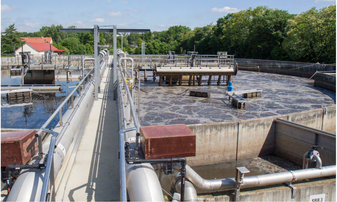
Wird bis 2020 erweitert: Kläranlage Potsdam-Nord
