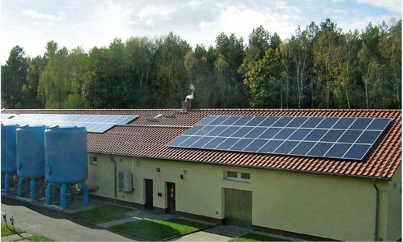
Photovoltaikanlage auf dem Dach des Wasserwerkes Ferch
