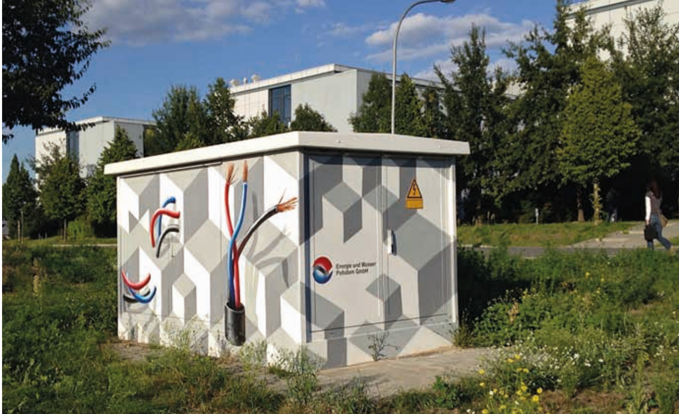
Gestaltete Trafostation, Golm In der Feldmark
