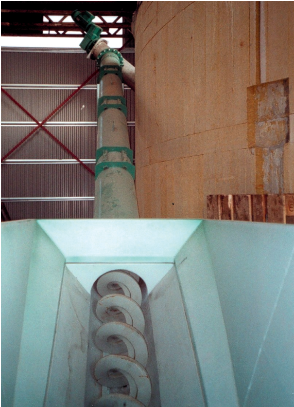
Abb. 12.4: Biogasanlage Dolgeln: Detailansicht der Förderschnecke zur Silageeinspeisung in den Fermenter
