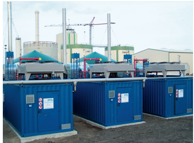
Abb. 9.1: Die Biogasanlage Senftenberg wurde im September 2006 eingeweiht und ist mit 3 MW die größte Anlage in Brandenburg. Es werden ausschließlich nachwachsende Rohstoffe eingesetzt. Im Vordergrund die BHKW-Container. Die Anlage wurde vom Brandenburgischen Wirtschaftsministerium gefördert.
