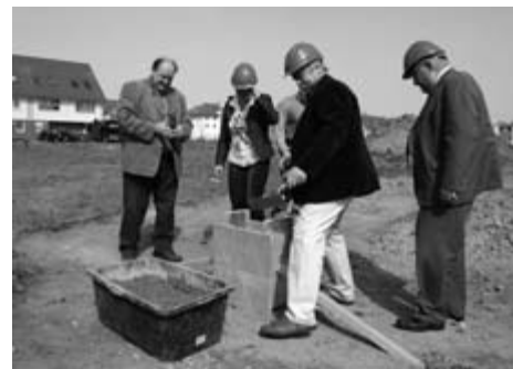
Bewegung an der Weinbergstraße: viele Häuslebauer haben jetzt mit den eigenen vier Wänden begonnen. Auch der Landesanglerverband wird bald sein „Zuhause“ hier haben. Foto: U.K.
