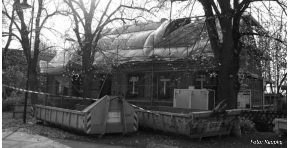
Die alte Tremsdorfer Schule wird 2011 hoffentlich in ihrem Hofladen die ersten Kunden erwarten dürfen. Im November riss der Wind aber kräftig an den Folien auf dem Dach.
