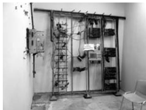
Auch die Nachrichtenschaltanlage ist verwaist.
