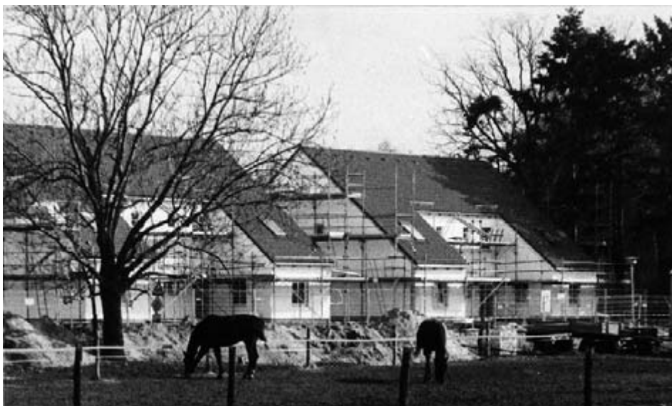
Die Gagfah-Siedlung im Bau, gesehen von der damaligen Pferdekoppel gegenüber. Die Gemeinde wollte Bergholz-Rehbrückern, die nach der Wende von Restitutionsansprüchen betroffen waren, und anderen jungen wohnungssuchenden Familien die Möglichkeit eröffnen, auf diesem Grundstück Wohneigentum zu erwerben. Da die Baukosten sich durch ungünstigen Baugrund erhöhten (es mussten Pfahlgründungen erfolgen), verteuerten sich die Häuser allerdings so, dass die Anwärter aufgaben.
