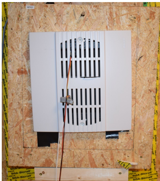
Abbildung 20 Dezentrales Lüftungsgerät mit Abdeckung; In der Wand verbaut
