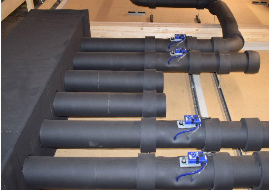
Abbildung 19: Reglerklappen zur Einstellung der Volumenströme der zentralen Lüftungsanlage
