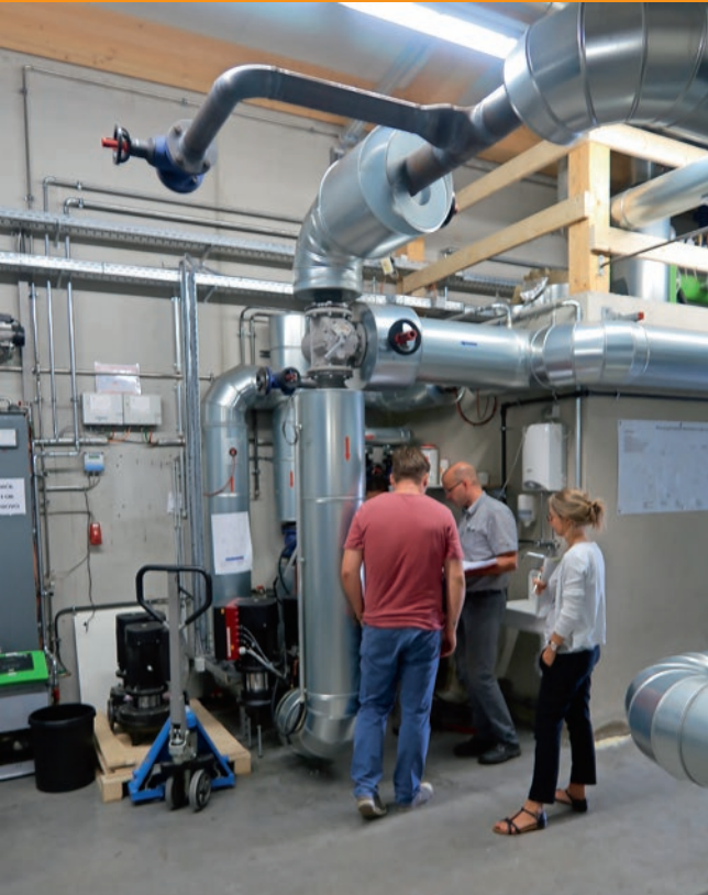
Abb. 2: Besichtigung eines Fernwärmesystems gemeinsam mit dem Betreiber. Bild: Isabelle Bückler
