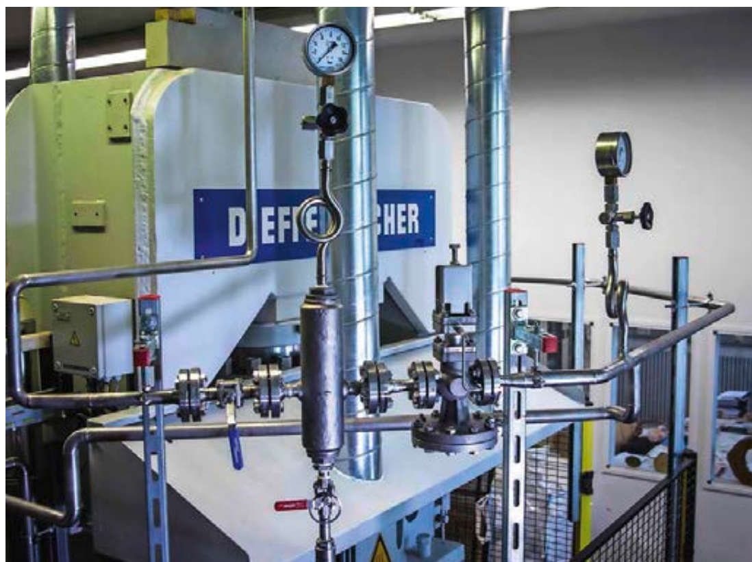
Abb. 3: Für die Herstellung von Holzfaserdämmstoffen wurde eine Dampf injektions- presse installiert.
