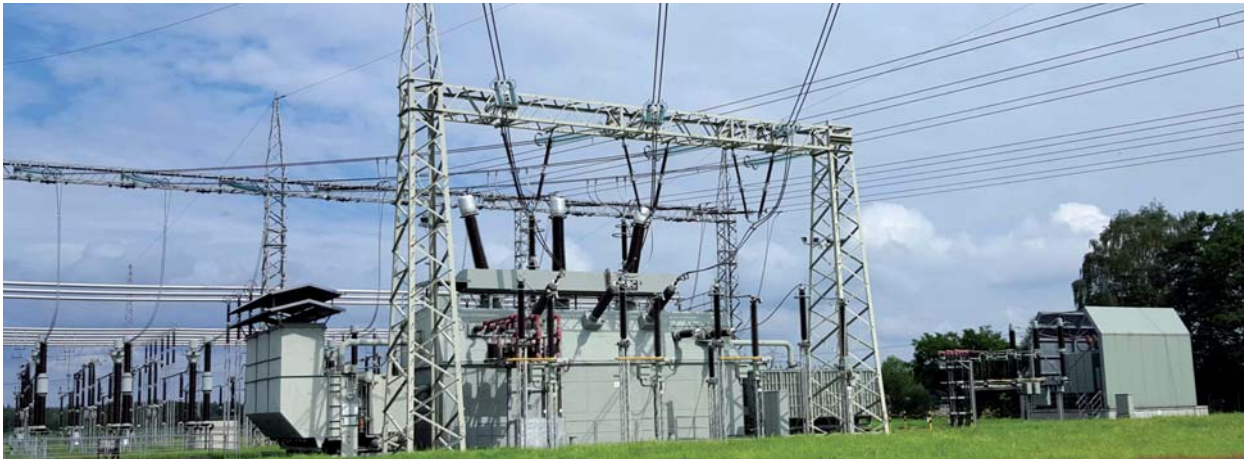
Stromnetz mit Umspannwerk
