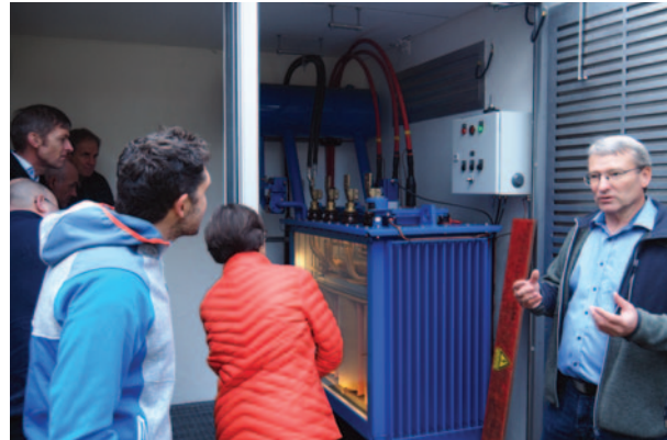
Prof. Dr.-Ing. Oliver Brückl gibt den Lehrer:innen einen Einblick auf den vor knapp 10 Jahren erbauten ersten regelbaren Ortsnetztransformator (RONT).
