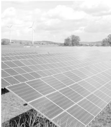
Abbildung 5: Photovoltaikanlage, Quelle: Voswinckel & Wesselak, 2016
