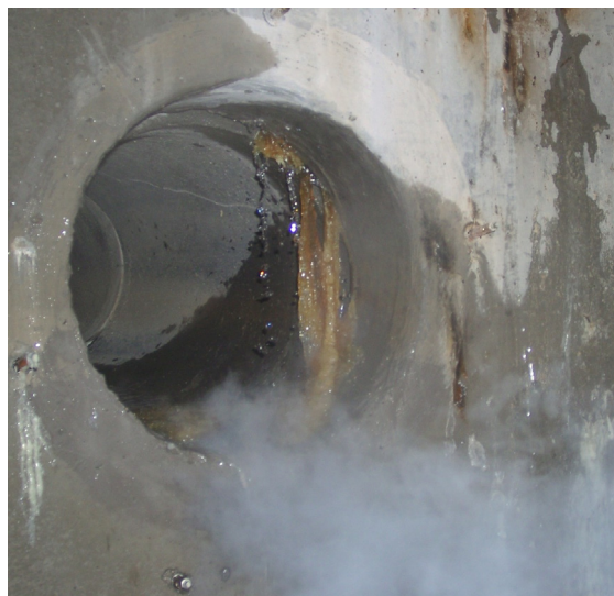
Bild 6.25: Austritt der Injektionsschmelze und Wasserdampfbildung infolge Kontakts mit Wasser
