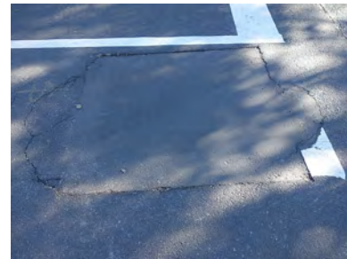
Bild: Mangelhafte Verdichtung des Verfüllmaterials ruft Sackung der Asphaltdecke und Nachbrüche im Randbereich hervor Foto: Best
