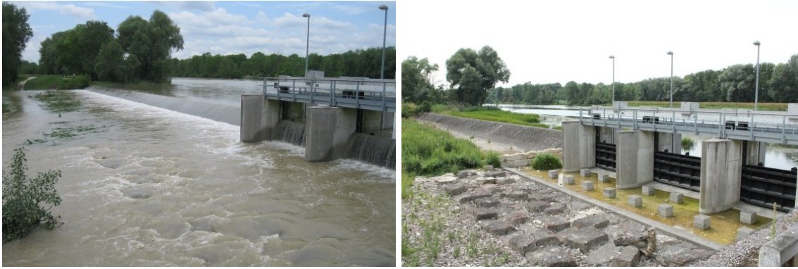
Abb. 4-14: Ausleitungsbauwerk für Ökologische Flutungen. Links: mit dem ca. 100 m langen (aktiven) Streichwehr und überströmten Schütztafeln während des Juni-Hochwassers (Foto: Peter Fischer, 2013). Rechts: mit geschlossenen Schütztafeln und Einbauten im Tosbecken (Foto: Peter Fischer, 2015).
