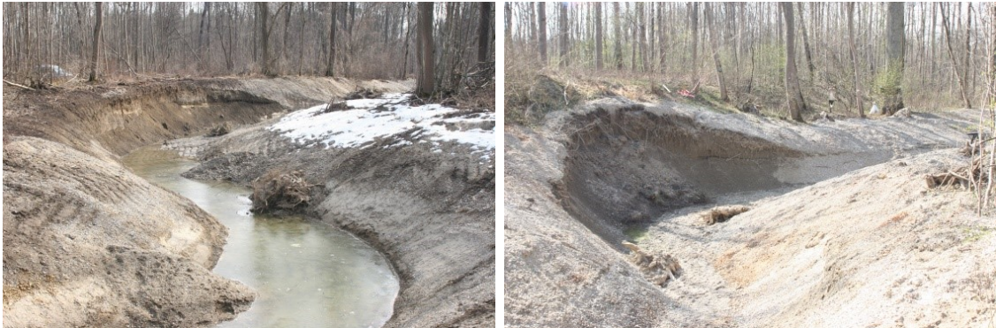
Abb. 4-19: Standort an der „Radwegbrücke“. Links: „Prallhang 1“ kurz nach den Bauarbeiten (Foto: Peter Fischer, 2010); Rechts: „Prallhang 2“ kurz nach den Bauarbeiten (Foto: Peter Fischer, 2010).
