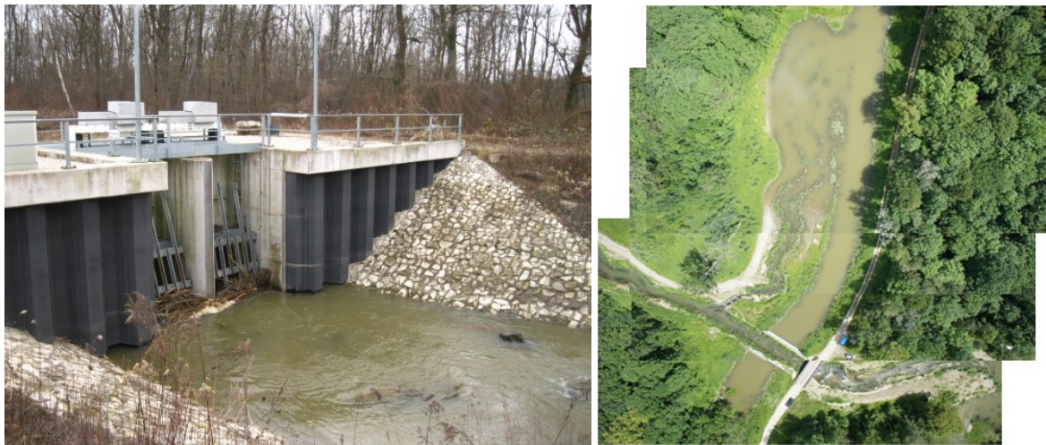
Abb. 4-15 Drosselbauwerk und aufgestauter Längesmühlbach. Links: Drosselbauwerk (offen) (Foto: Peter Fischer, 2013). Rechts: aufgestauter Bereich um die Trgbrücke im Oberwasser des Längesmühlbaches (Luftbild aus UAV-Befliegung: Peter Fischer, 2012).
