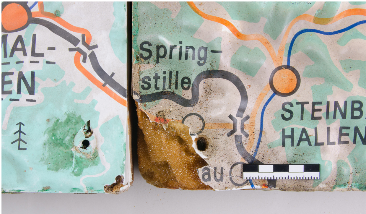
Abb.12: Plattenstoß an der Südseite der Segmente „K8 Eisenach“ (rechts) und „J8 Gotha“ (links);
