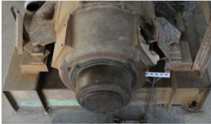
Abb. 13: westlicher Teil des Generators mit kleinem Gehäuse und geschmolzenem Kasten der Generatorsteuerung
