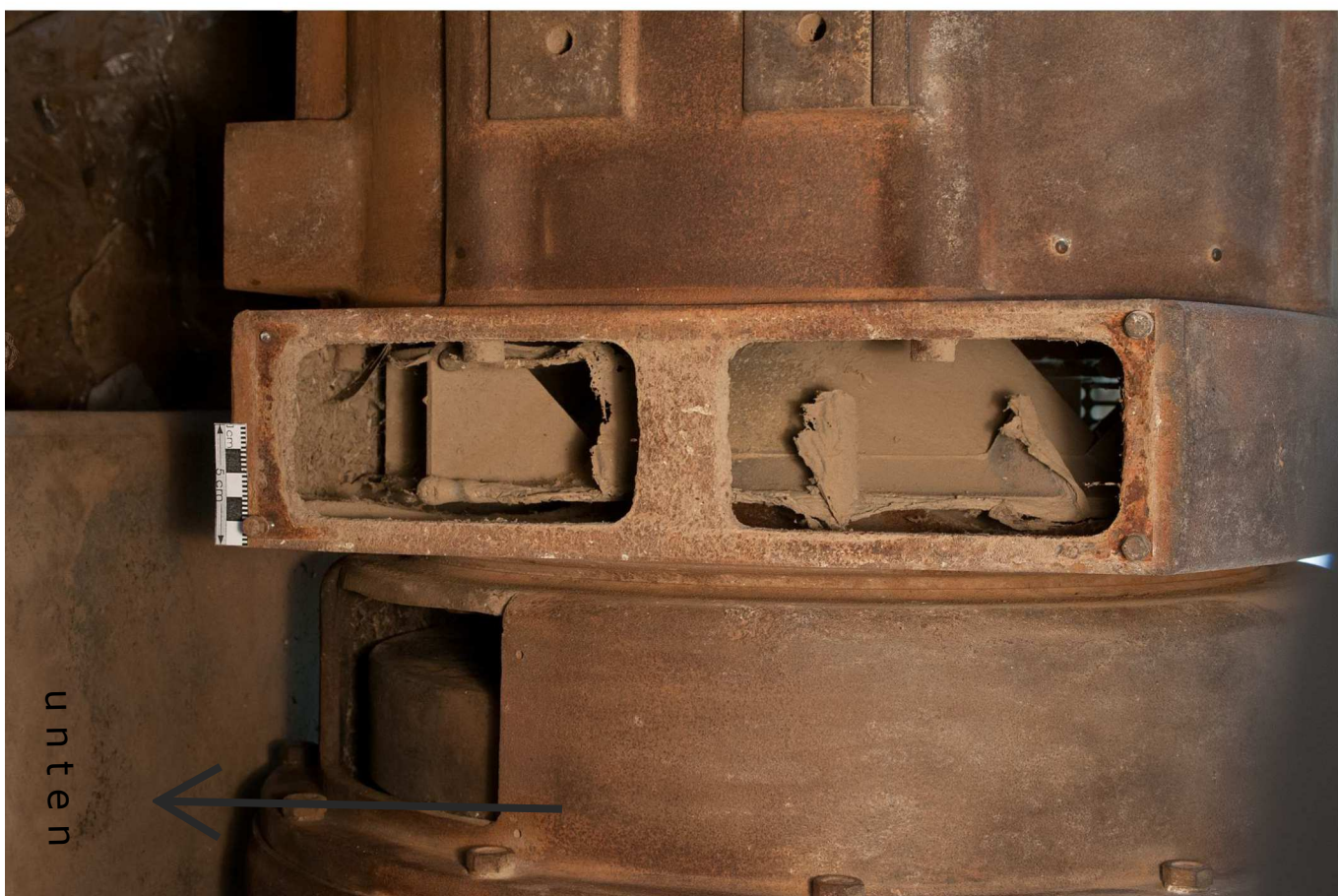
Abb. 16 Geschmolzenes Lüfterrad im Generator. (Foto Jaßmann)
