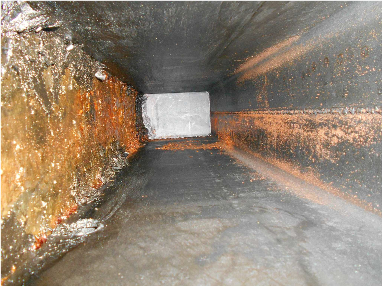
Abb. 11 Tank innen, reich an Ablagerungen und Korrosionsprodukten. (Foto Klein 2015)
