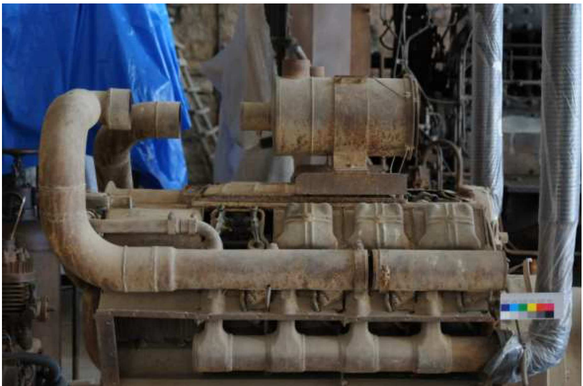
Abb.19: Nordseite, oberer Teil des Motors, Vorzustand
