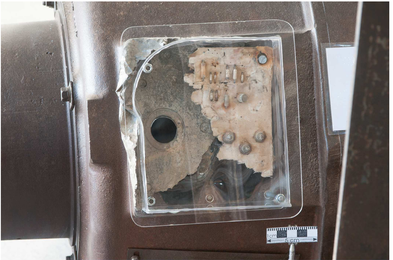
Abb. 43 Ergänzung der unteren Generatorsteuerung mit Leiterplattenfragment
