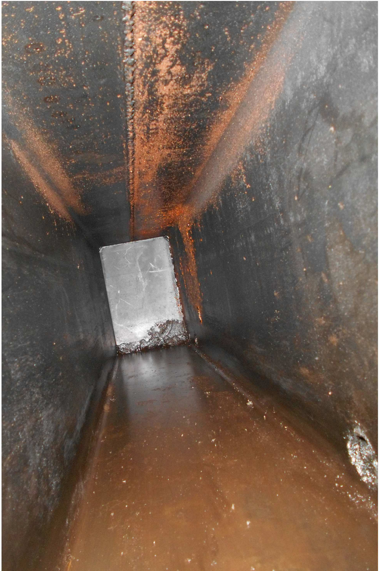
Abb. 39 Tank innen, nach der Reinigung und Konservierung. (vgl. Abb. 11 vor den Maßnahmen). (Foto Jaßmann)
