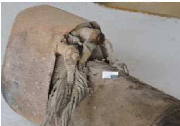
Abb.49: Anlasser mit Kabeln, Vorzustand
