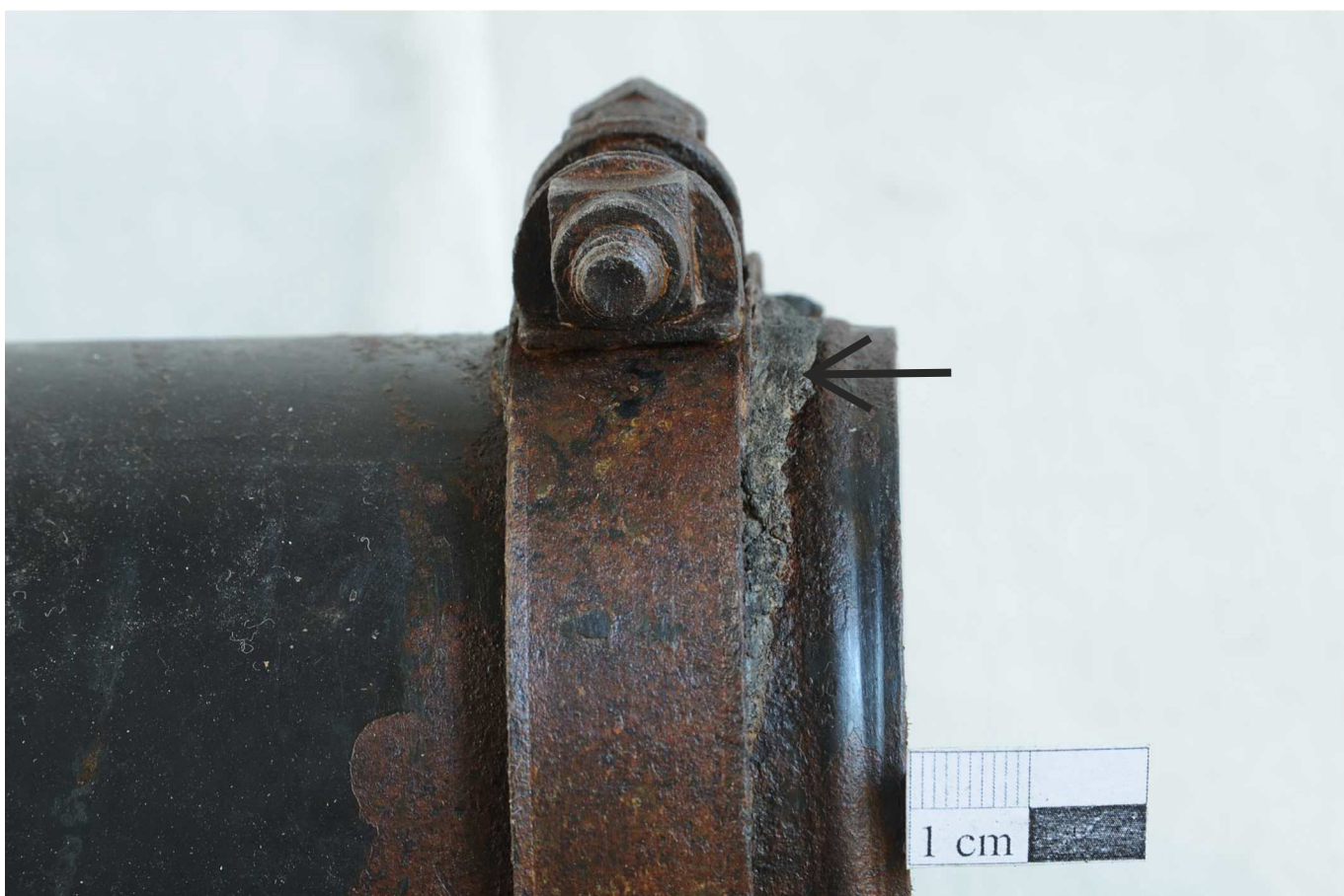
Abb. 61 Ansaugsammelrohr, Detail, Zustand nach der Entfernung der Korrosion, der Konsolidierung und der Konservierung mit Wachs. (Foto Jaßmann)
