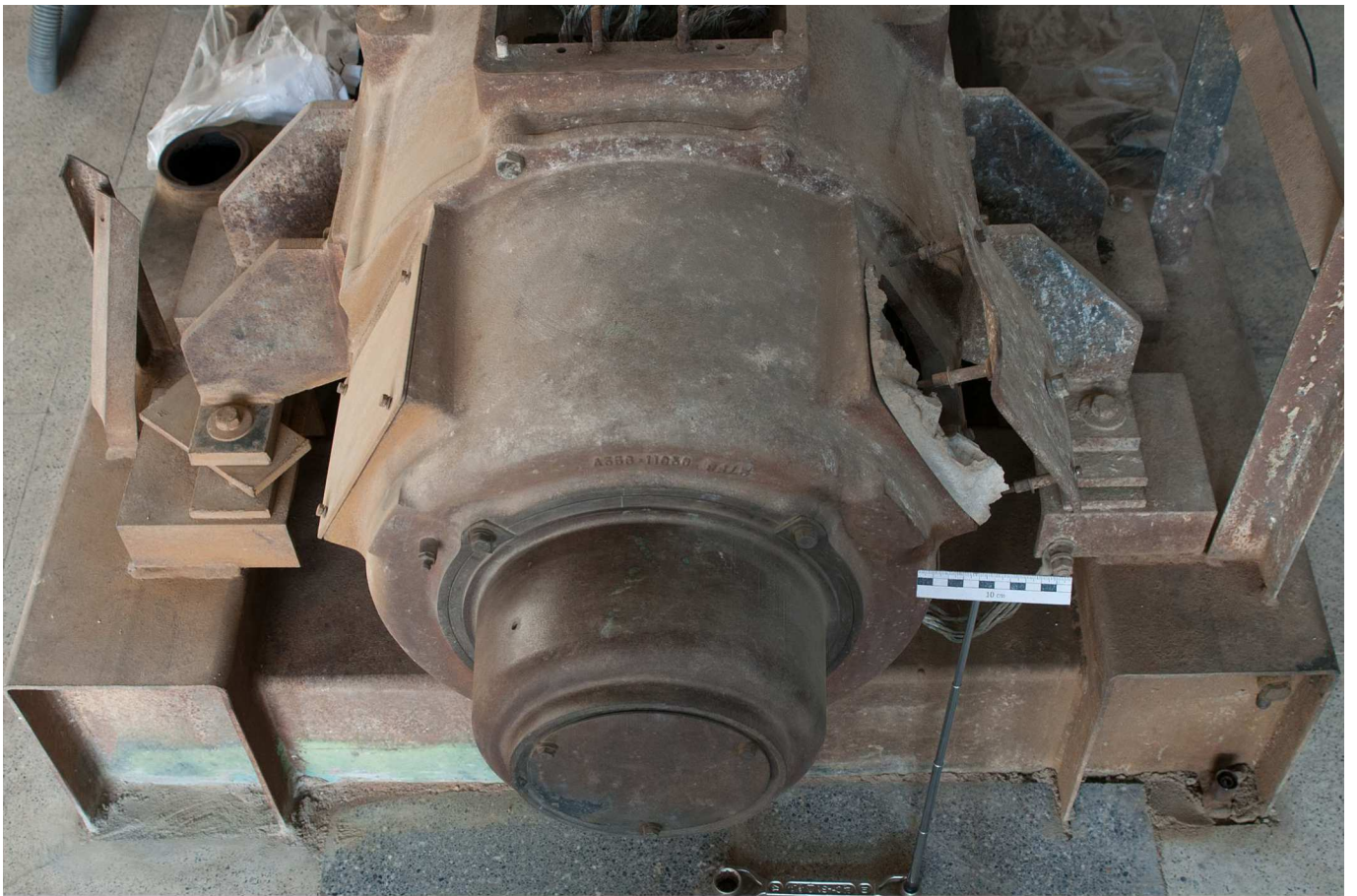
Abb. 13 Westlicher Teil des Generators mit kleinem Gehäuse und geschmolzenem Kasten der Generatorsteuerung. (Foto Jaßmann)
