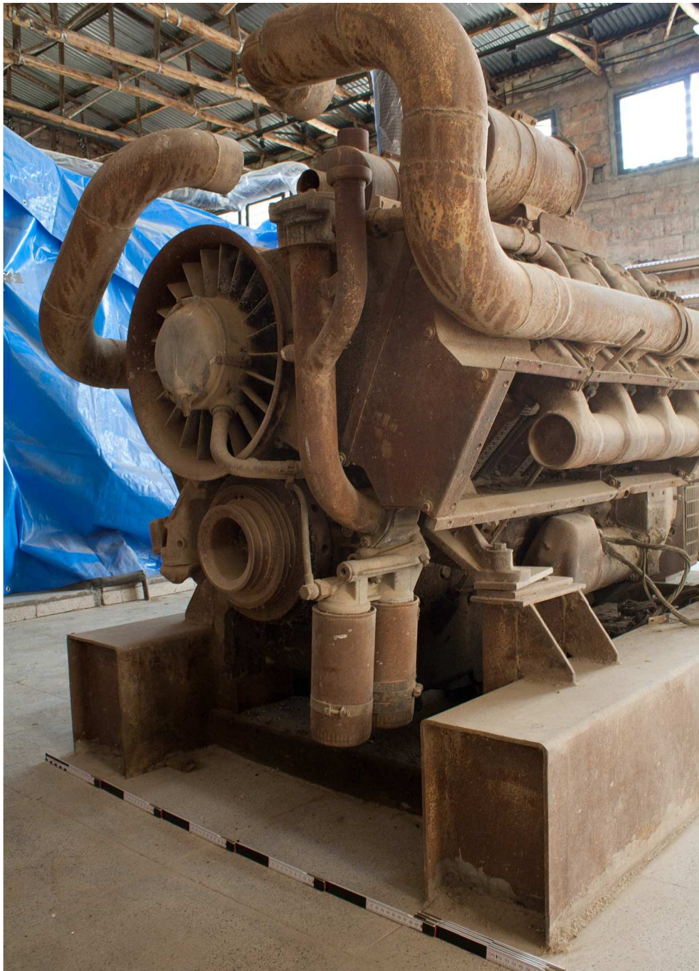
Abb. 22 Motor, Ostseite, Zustand vor Restaurierung. (Foto Klein)
