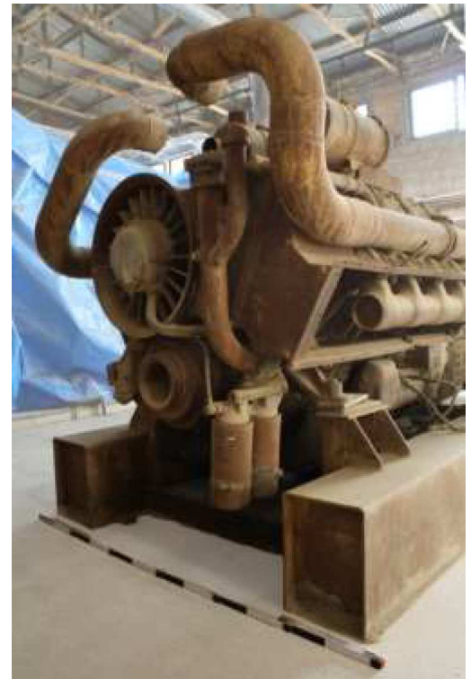
Abb. 22: Motor, Ostseite, Vorzustand
