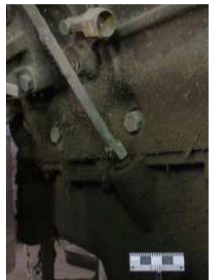
Abb. 18: ölige Auflagerungen auf Motorblock und Ölwanne
