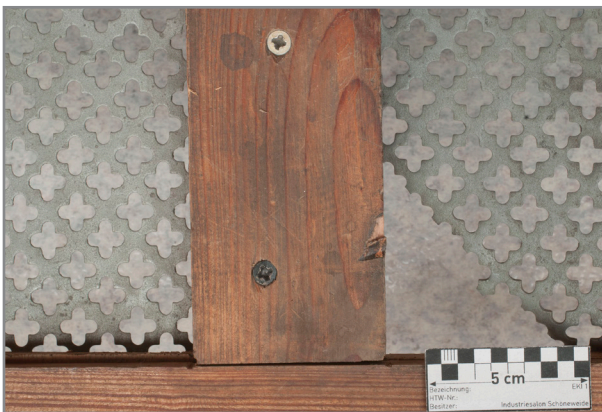
Abb. 304: Detail Innenraum Boden, Fehlstelle in mittlerem Gitter, nach der Trockenreinigung
