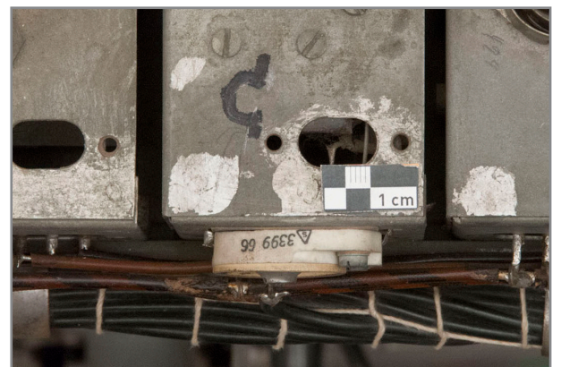
Abb. 347: Detail Oberseite Elektronikgestell, Frequenzteilerketten, Bezeichnung des Chassis mit schwarz „C“
