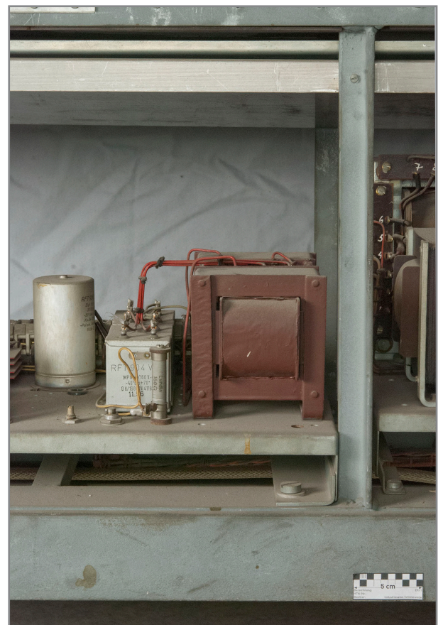
Abb. 422: Detail Rückseite Elektronikgestell, Netzgerät „III“, zylindrischer Elektrolytkondensator, Metallpapierkondensatoren mittig, rechts eine roter Transformator
