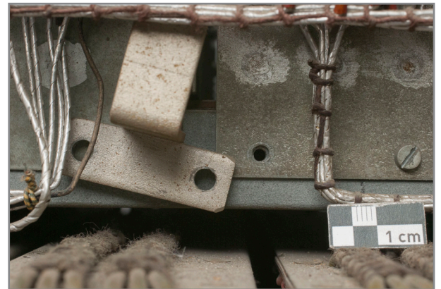
Abb. 524: Detail Spielseite Elektronikgestell, fehlende Schrauben an den Chassis der Frequenzteilerkette „Dis“
