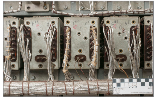
Abb. 546: Detail Spielseite Elektronikgestell, Tastsysteme Oberwerk „f#1 g1“, „g#1 a1“ und „a#1 h1“, Kabel des ersten und letzten ohne Kabelbaumbindung
