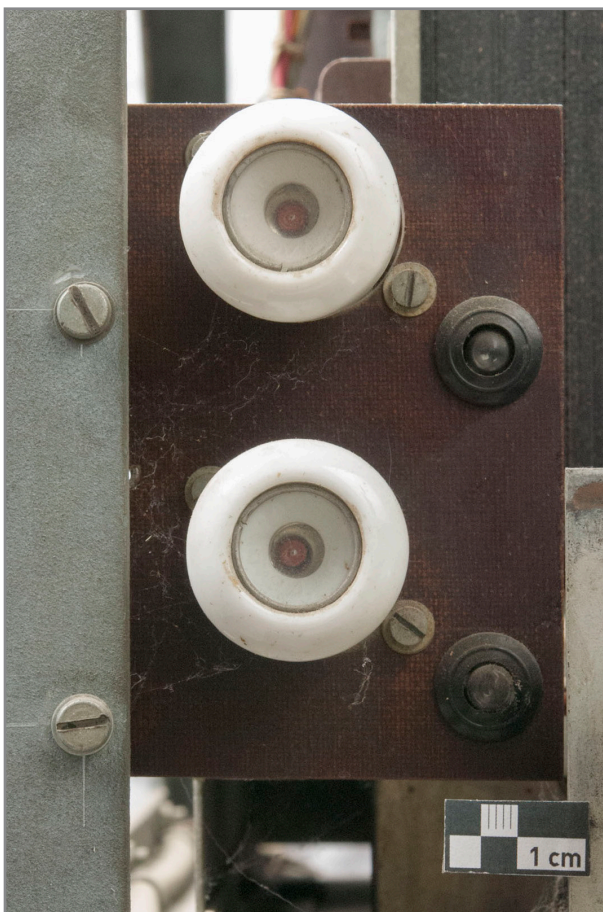
Abb. 425: Detail Rückseite Elektronikgestell, Netzgerät „II“ Sicherungen
