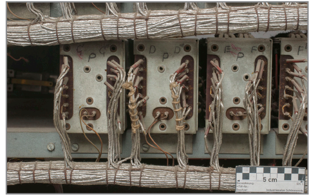
Abb. 568: Detail Spielseite Elektronikgestell, Tastsysteme Pedalwerk „C C#“, „D D#“ und „E F“, Kabel des ersten und letzten ohne Kabelbaumbindung
