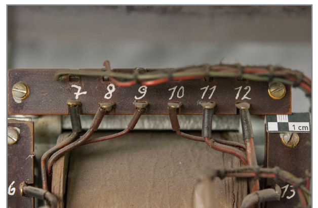
Abb. 442: Detail Rückseite Elektronikgestell, Netzgerät „I“, Kontakte des Transformators
