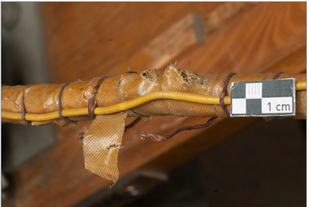
Abb. 598: Detail Kabelbaum, zum Teil aufgebrochener und abgerollter Textilschutz
