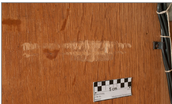
Abb. 275: Detail Innenraum rechtes Seitenteil, Ausbrüche im Holz hinten oben
