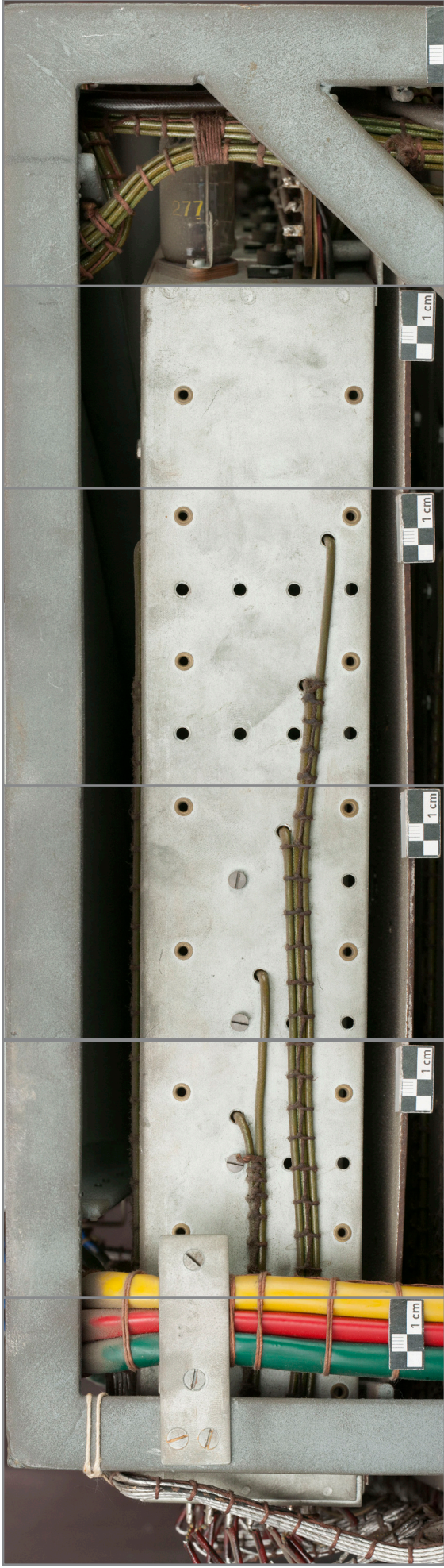
Abb. 490-495: Detailsicht rechte Seite des Elektronikgestells, obere Ebene Tastsysteme
