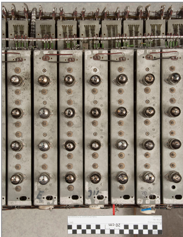
Abb. 332: Detail Oberseite Elektronikgestell, nach der Trockenreinigung, ein Chassis der Frequenzteilerkette des Grundtons „F“, sowie je zwei Chassis der Grundtöne „E“, „Dis“ und „D“
