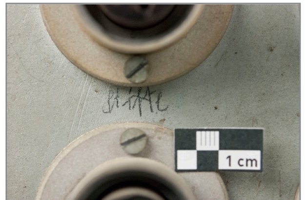
Abb. 446: Detail Rückseite Elektronikgestell, Bleistiftbezeichnung eines Kabelanschlusses für ein Tonkabinett „Stifte“
