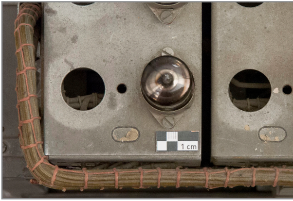
Abb. 334: Detail Oberseite Elektronikgestell, Sammelschienenverstärker, abblätternde Bezeichnungsklebschen
