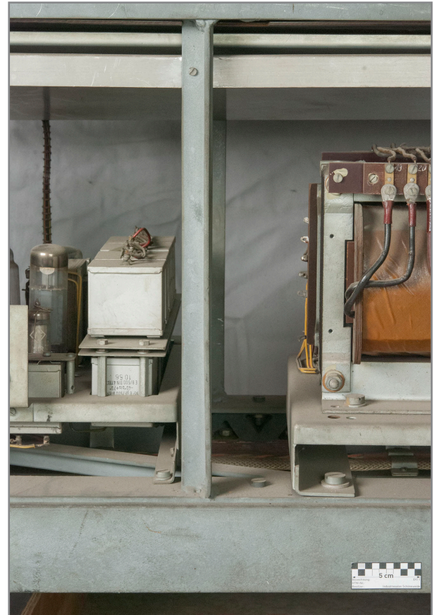
Abb. 420: Detail Rückseite Elektronikgestell, Netzgeräte „II“ und „III“, Metallpapierkondensatoren links, ein Transformator rechts im Bild
