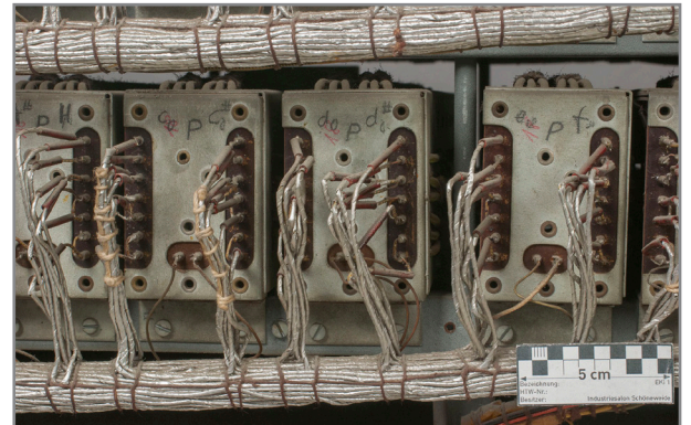
Abb. 570: Detail Spielseite Elektronikgestell, Tastsysteme Pedalwerk „C C#“, „D D#“ und „E F“, Kabel des zweiten und dritten ohne Kabelbaumbindung, eingedrückt
