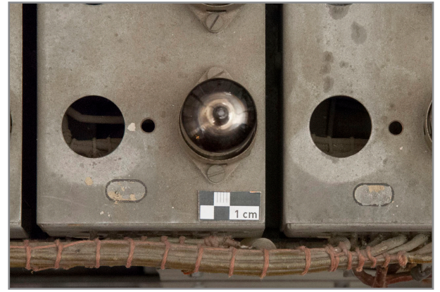
Abb. 335: Detail Oberseite Elektronikgestell, Sammelschienenverstärker, abblätternde Bezeichnungsklebschen
