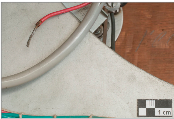
Abb. 265: Detail Innenraum der Spielseite „rechts“ mit Metallstütze und gelöstem Kabel
