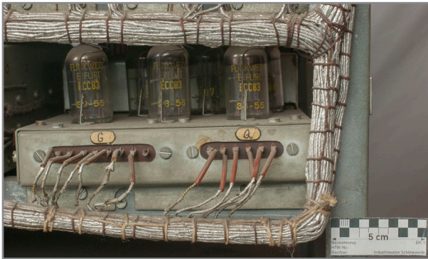
Abb. 577: Detail Spielseite Elektronikgestell, Störkompensation mit Bezeichnungsklebschen „G“ und „Q“, sehr eingedrückte Kabel an den Kontakten des „Q“, 7 Elektronenröhren des Typs ECC 83
