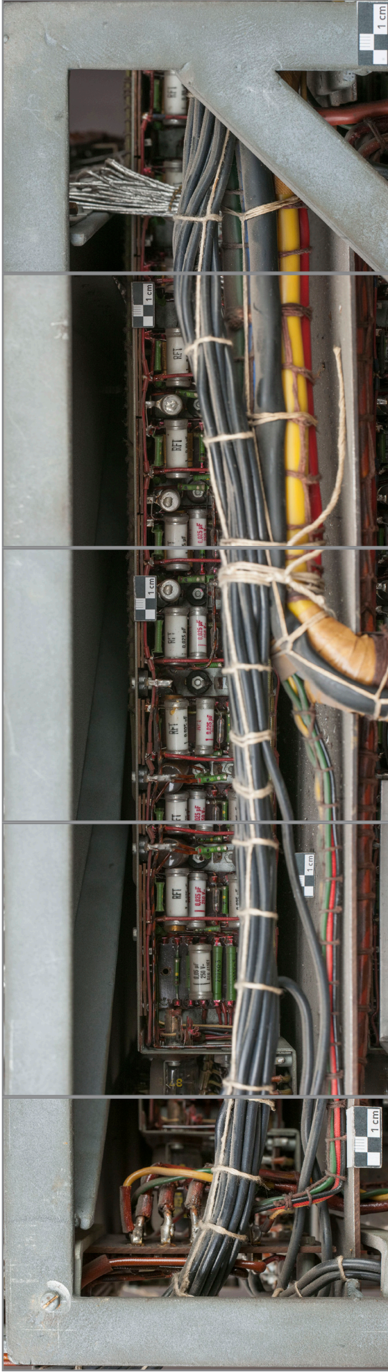
Abb. 460-464: Detailsicht linke Seite des Elektronikgestells, obere Ebene Tastsysteme, Einblick in ein Tastsystemchassis mit Porzelenkondensatoren, Widerständen, Verkabelung
