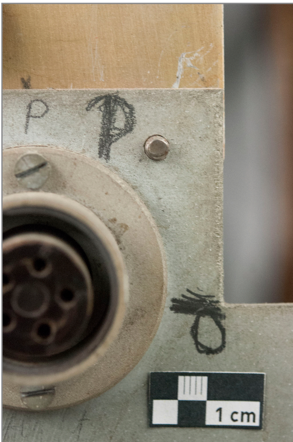
Abb. 445: Detail Rückseite Elektronikgestell, Bleistiftbezeichnung Kabelanschluss für Tonkabinett „P“
