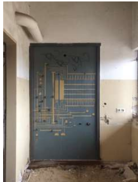
Abb. 152: Leuchtwarte im EG, Speicher 2.
