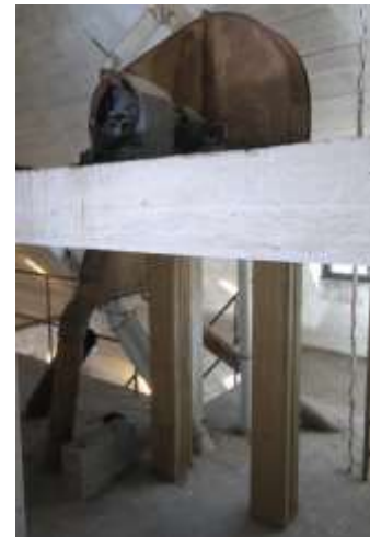
Abb. 35: Becherwerk-Kopf Speicher 1. Auswurf des vertikal nach oben beförderten Getreides.
