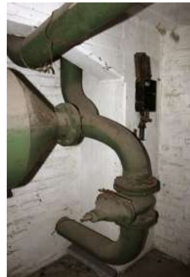
Abb. 143: Rohrführung und Konzentrationsmesser.
