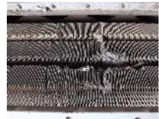
Abb. 119: Verzinkte Lamellenbleche zur Warmluftbereitung.
