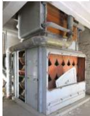
Abb. 113: Heiz- und Warmluftabteil 3. OG.
