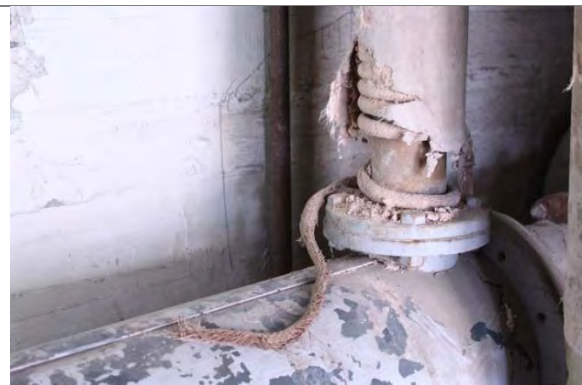
Abb. 348: S_P_106 (Seilform), S_P_107 (Außengewebe mit Gips?) Beides Asbest??
