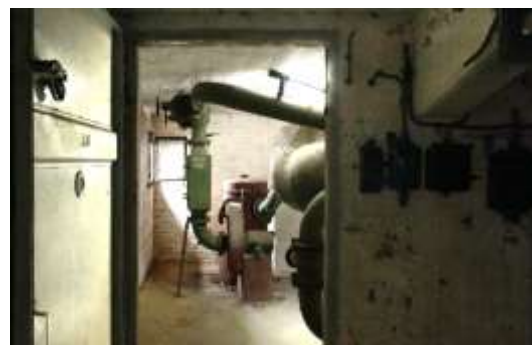
Abb. 141: Begasungsanlage mit gasdichter Tür und Kontrollanzeigern.
