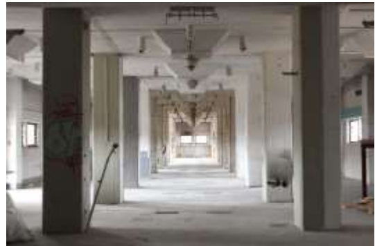
Abb. 137: Erdgeschoss Speicher 3. Jeweils vier Anschlüsse sind um die Siloauslässe angeordnet.
