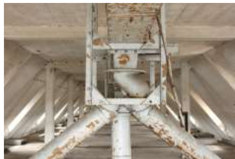
Abb. 63: Drehrohrverteiler, 6. OG, Speicher 3.
