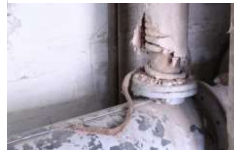
Abb. 128: Gelöste Rohrisolierung am Gegenstromapparat. Vermutlich Asbestschnur.
