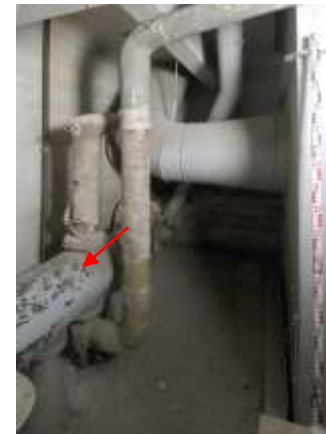
Abb. 120: Rückseite Trocknungsanlage, 2. OG mit Gegenstromapparat (Pfeil).
