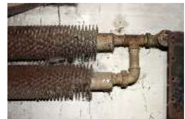
Abb. 136: Rippenrohrheizkörper im Kellergeschoss von Speicher 3.
