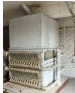
Abb. 112: Einlauf- und Heizabteil 4. OG.
