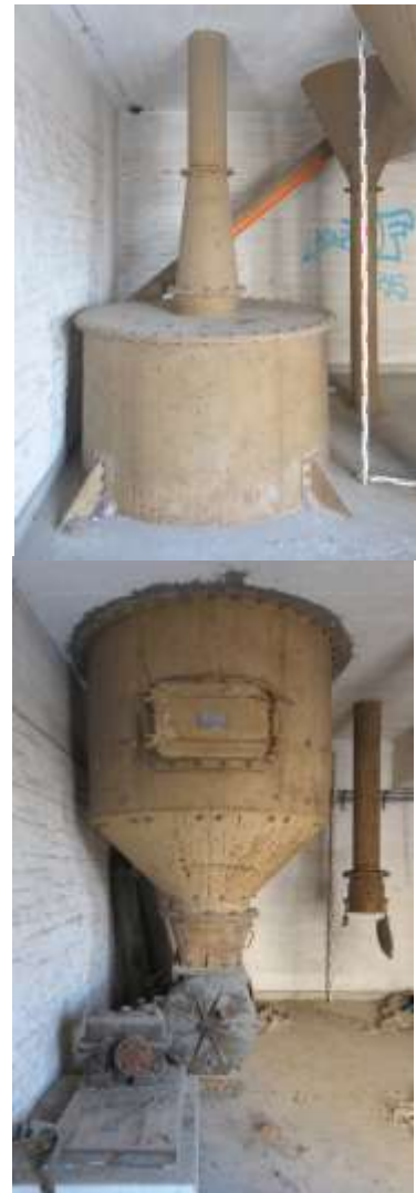
Abb. 24: oben: Obere Hälfte des Rezipienten im 2. OG, unten: Untere Hälfte des Rezipienten, 1. OG von Speicher 2.
