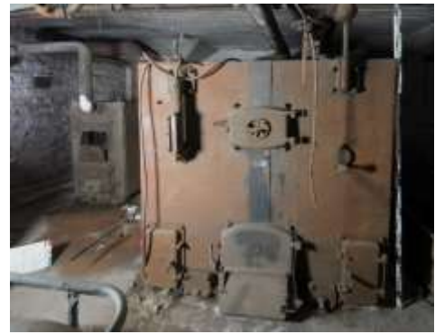
Abb. 132: Heizraum mit Strebel -Kessel (Vordergrund) und Buderus-Lollar -Kessel (hinten links).
