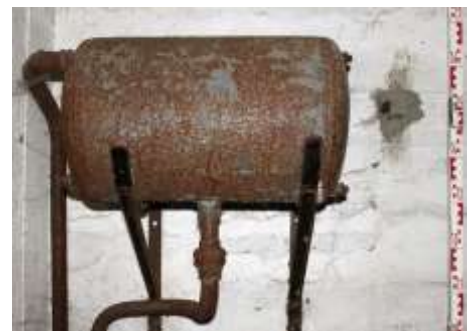
Abb. 150: Tank 1. OG, Speicher 2.
