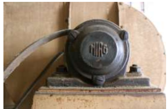
Abb. 10: Transmissionsantrieb eines Ventilators mit MIAG-Beschriftung. Speicher 3, 4. OG.
