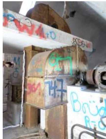
Abb. 37: Becherwerksköpfe Speicher 2. Ockerfarbene Sichtbeschichtung durchsetzt mit Korrosionsprodukten.
