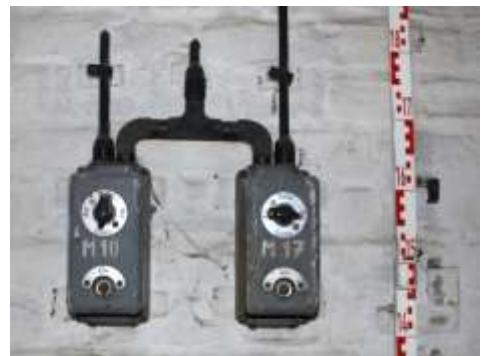
Abb. 156: Letzte erhaltene Einzelansteuerung der Maschinen. Hier M10: Aspirateur, M17: Schleuse.
