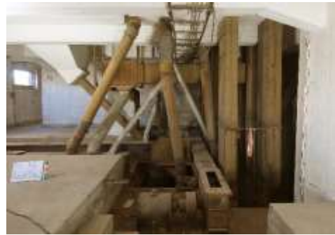
Abb. 51: Drei Antriebsstationen von TKF im KG, Speicher 2. Im Vordergrund TKF als Querförderer von der Ostseite. Von links kommt: TKF-Transport vom Silospeicher. Oben: TKF als Sammelförderer auf der Längsachse des Speichers.
