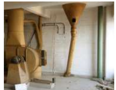
Abb. 98: Zyklon und Ventilator, 4. OG.
