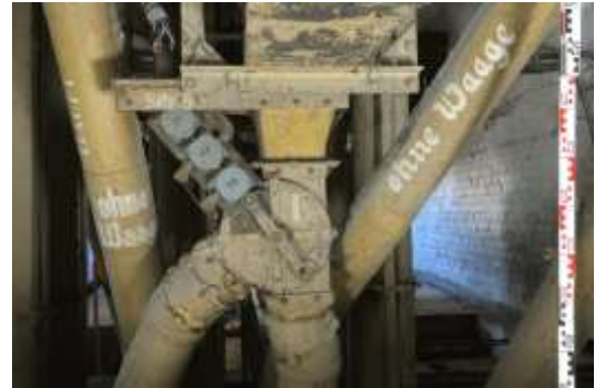
Abb. 9: Fallrohre zu Becherwerken, Speicher 2, KG.
