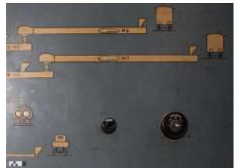
Abb. 153: Detail Leuchtwarte. Annahme-TKF mit Cellon -Pfeilen. Darunter Auslösedruckknopf für die Hupe.
