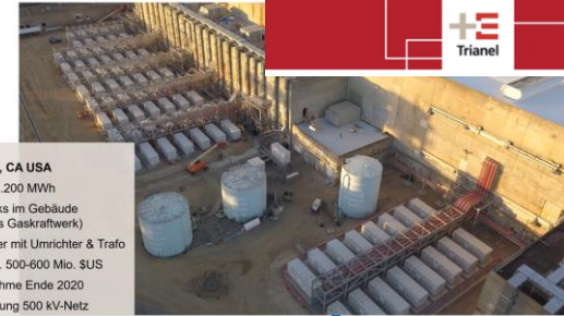
Größte Batterie weltweit 300 MW / 1.200 MWh, Moss Landing
