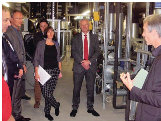
PROF. DR. ADAM (RECHTS) ERKLÄRT DEN ANWESENDEN BEI DER BESICHTIGUNG DER ABSORPTIONSKÄLTEMASCHINE IN DER KÄLTEZENTRALE DAS FUNKTIONSPRINZIP
