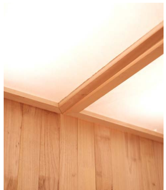
Abb. 317: Badezimmerbeleuchtung mittels abgehängter Paneele, bespannt mit Japanpapier
