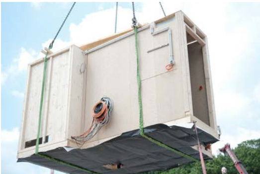
Abb. 307: Vorinstalliertes Raummodul für die Haustechnik
