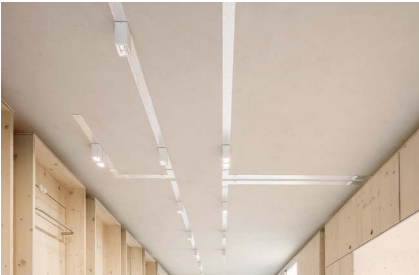
Abb. 61: Aufputz Elektroinstallation – Foto: Nicolai Rapp
