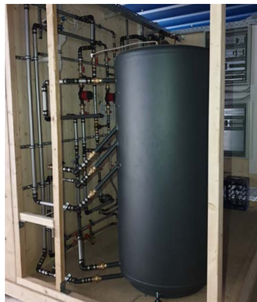
Abb. 312: Blick in den vorinstallierten Technikraum
