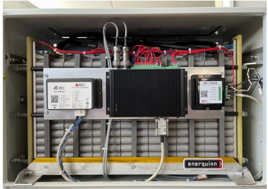
Abb. 313: Batterie mit Managementsystem und Kommunikationseinheit. Aufgebaut aus 980 Einzelzellen. Der Kontakt zwischen den Zellen wird über Schrauben und Spannfedern hergestellt
