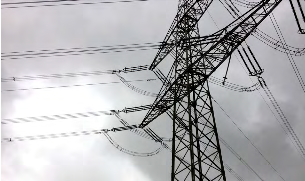
Abbildung 4.11: Hochspannungsmast mit Viererbündeln einer 380 kV - Leitung, erkennbar an jeweils 3 in Reihe liegenden Isolatoren
