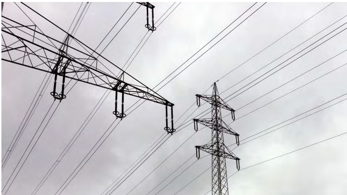
Abbildung 4.10: links ein Hochspannungsmast mit Zweierbündeln einer 220 kV - Leitung, erkennbar an jeweils 2 in Reihe liegenden Isolatoren, rechts zwei 110 kV-Leitungen
