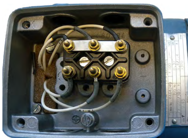
Abbildung 2.7: Klemmkasten einer Asynchronmaschine; deutlich zu erkennen die Kontaktbrücke für die Klemmen U_2 , V_2 und W_2
