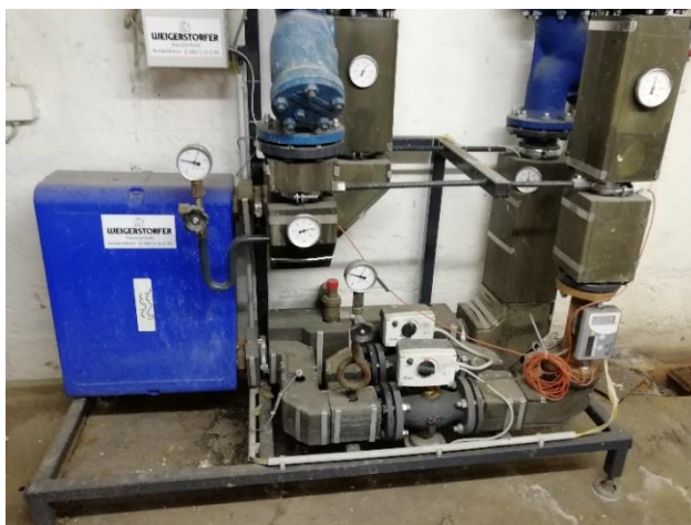
Abbildung 1-C: Fernwärmeübergabestation mit isoliertem Plattenwärmetauscher (blau)
