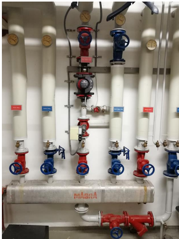
Unterverteilung Neues Rathaus
