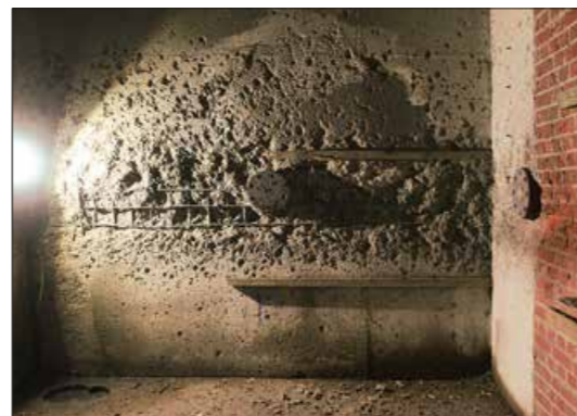
Abb. 2: Bunkerinnenraum nach Sprengung einer RSM-Ladung
