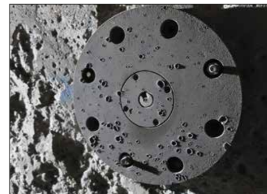
Abb. 3: Drucksensor in der Bunkerwand
