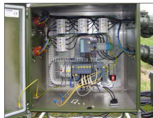
Abb. 2: Dezentrale Messstation im Feldlager Putlos
